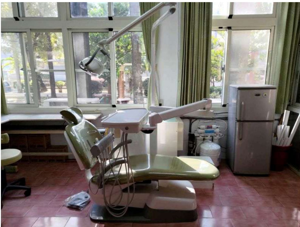
原診療椅老舊管線多處破損 圖片來源：記者林清雲
